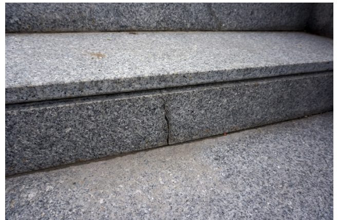
Abbildung 3: Mittelfristiger Mangel - Riss in der Setzstufe
