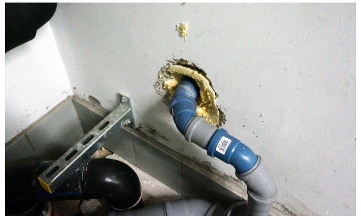
Abbildung 1: Kurzfristiger Mangel - Fehlende Brandabschottung
